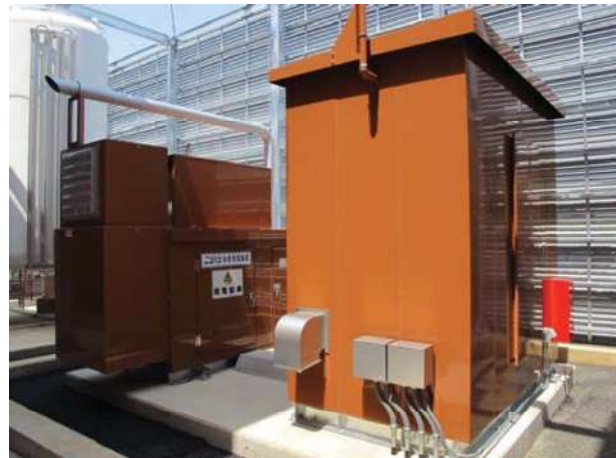
非常用発電機
