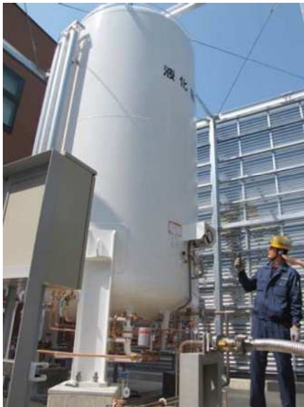
外部にある液体窒素供給タンク
